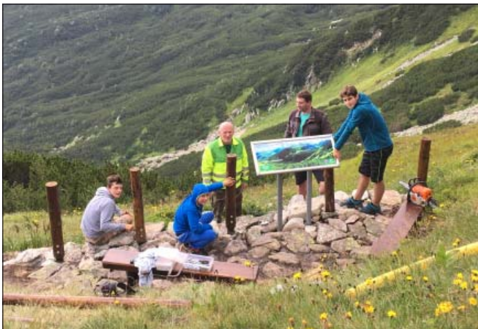
Ing. Vladimír Žák a Ladislav Matiščík s rodinou pri výstavbe Vyhlíadky Spálená
